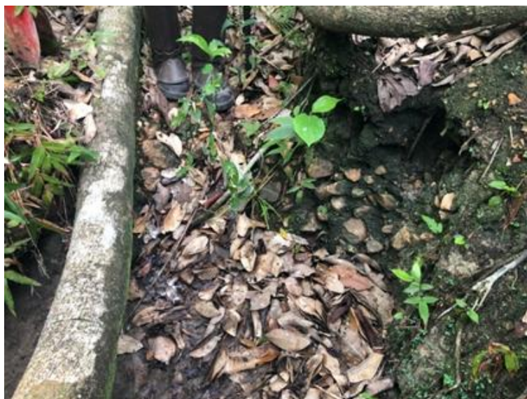
Figura 4.34 - Registro fotográfico da NC 02
