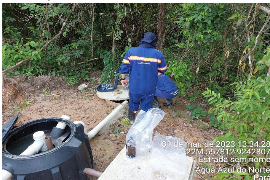
Figura 2.54 - Realização de monitoramento em sistema de tratamento de efluente sanitário
